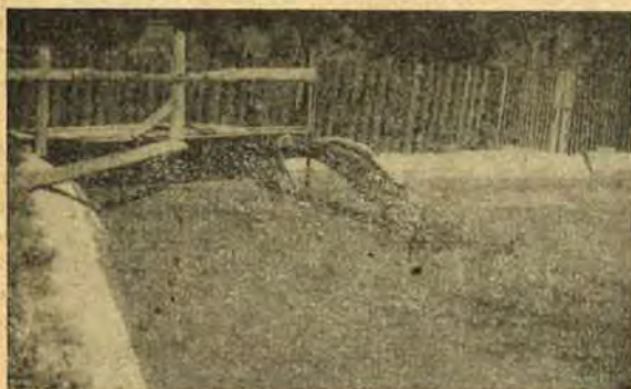
Rys. 16. Wpływ mieszaniny gruntowej z rurociągu do zbiornika przy przepompowni
