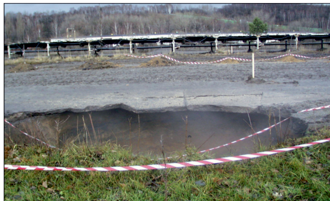
Fot. 11. Zapadlisko powstałe w wyniku pożaru chodnika
