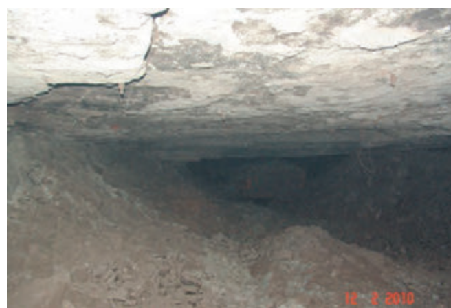
Rys. 5. Widok wyrobiska po zdarzeniu
