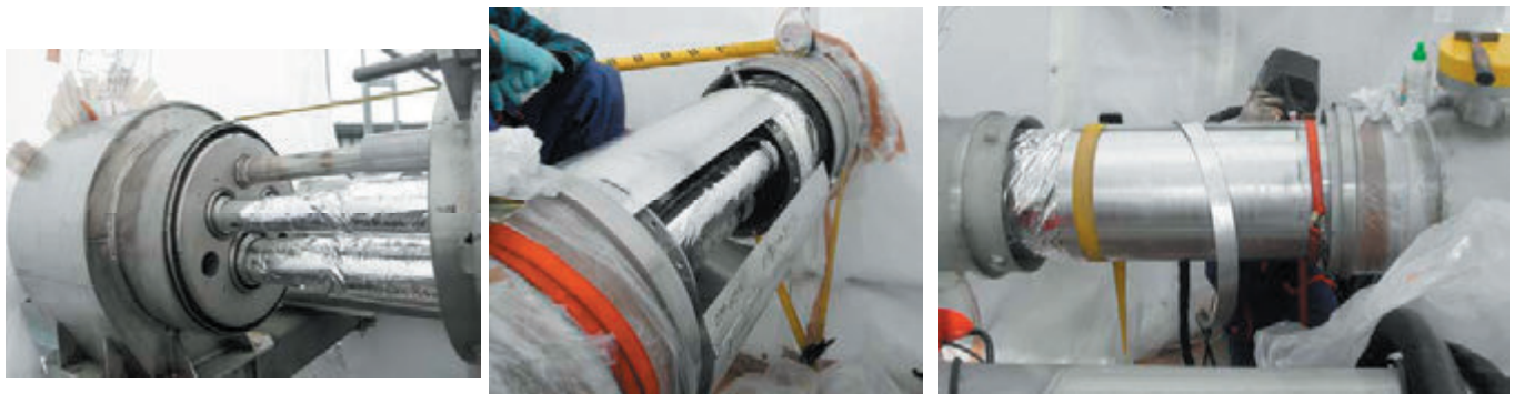
Rys. 11. Izolacje termiczne rur procesowych i ekranu
