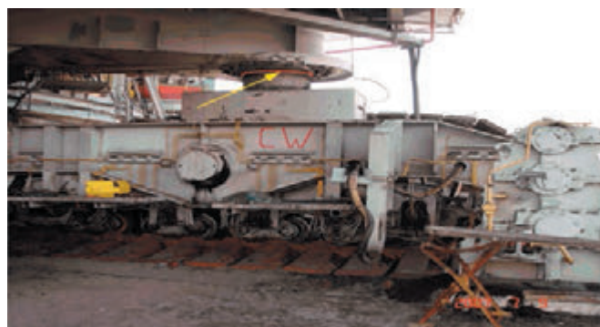
Rys. 2. Pęknięcia słupów podporowych koparki SRs-2000
