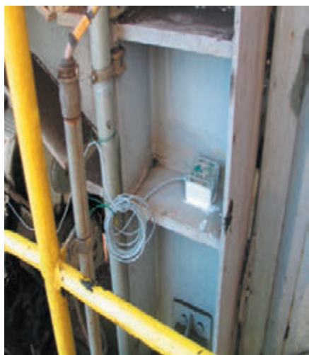
Rys. 5. Autonomiczny rejestrator dwukanałowy z pomiarów tensometrycznych
