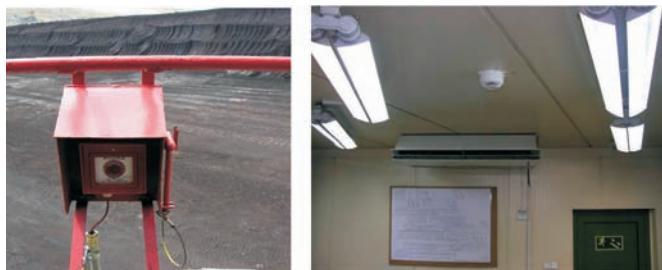
ręczny ostrzegacz pożarowy ROP czujka dymu DUR w rozdzielni elektr.
