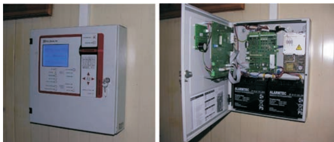
centrala sygnalizacji pożarowej POLON 4100
