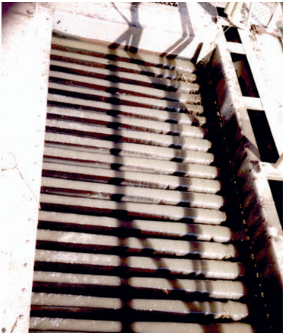
Fot. 5. Widok klarownika odwadniacza podczas pracy z zasuwą przelewu separatora HM całkowicie otwartą
