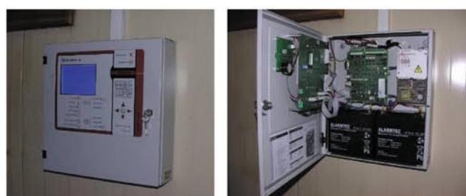
centrala sygnalizacji pożarowej POLON 4100
