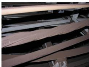
przewody w przewijakach kablowych
