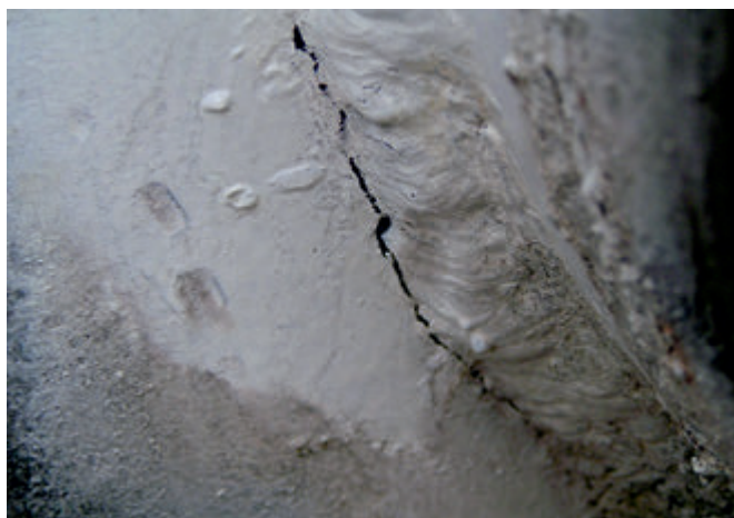
Rys. 5. Defektogram proszkowy pęknięcia eksploatacyjnego
