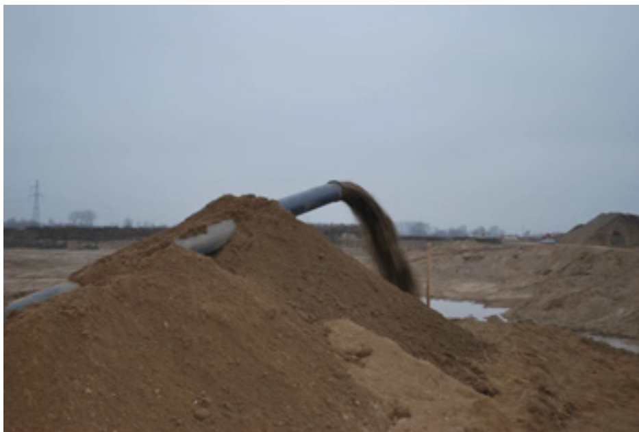
Fot. 17 Urobek z głowicy urabiającej firmy Dragflow składowany na brzegu wyrobiska do odwodnienia (źródło: www.Wichary.eu )
