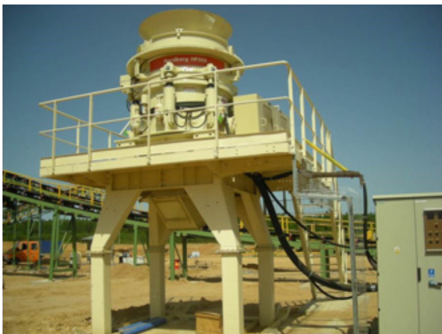
Fot. 66 Kruszarka HP 300 na konstrukcji nośnej (źródło: A. Witt 04.06.2008)
