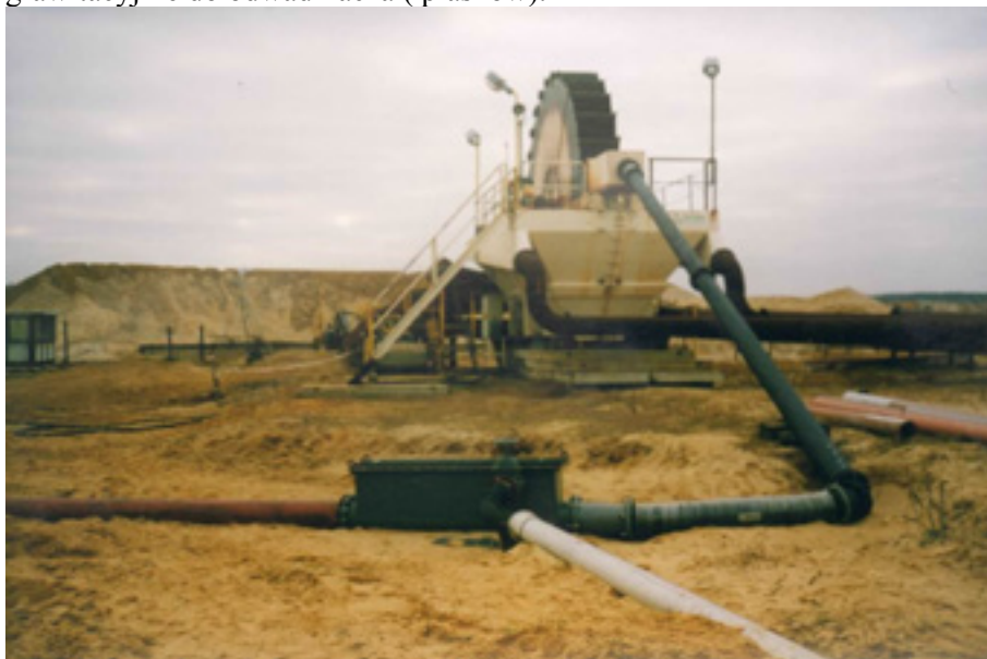
Fot. 86 Widok hydrokorektora membranowego podczas prób. Wariant I (źródło: Z. Schmidt 2007)
