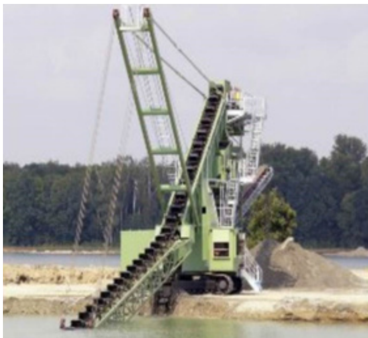
Fot. 35 Koparka łańcuchowa firmy Beyer urabiająca złożę piasku i żwiru spod lustra wody (źródło: www.beyer-viernheim.de/index.php/de/de-produkte/de-schwimmbagger/de-schwimmbagger-ausleger )
