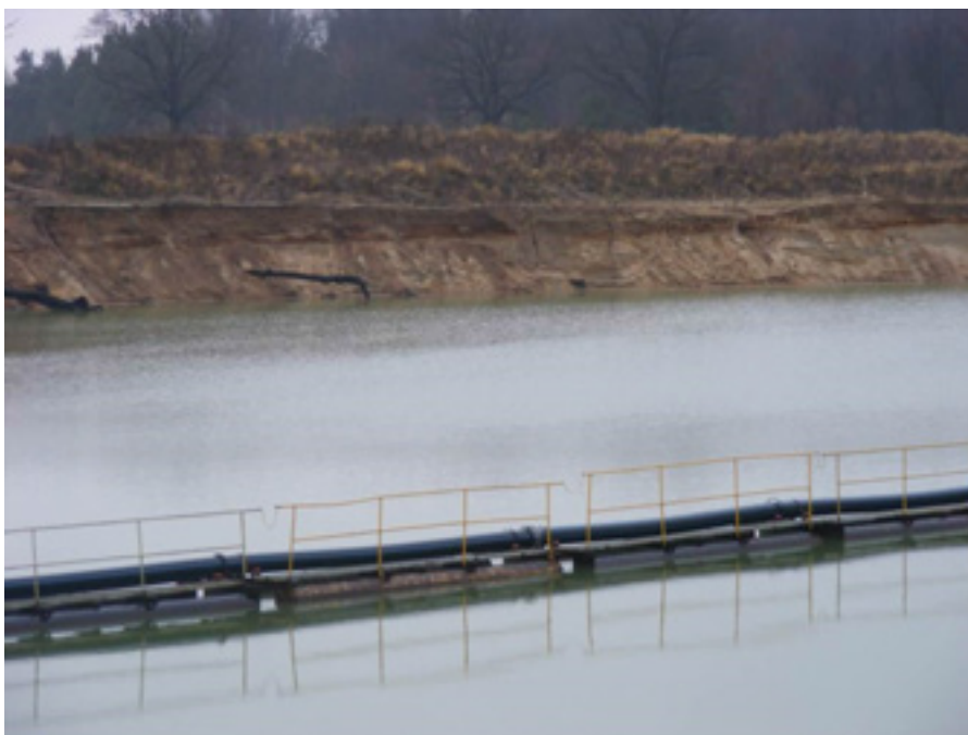
Fot. 13 Rurociąg na pływakach z chodnią i barierkami (źródło: Z. Schmidt 01.10.2012)
