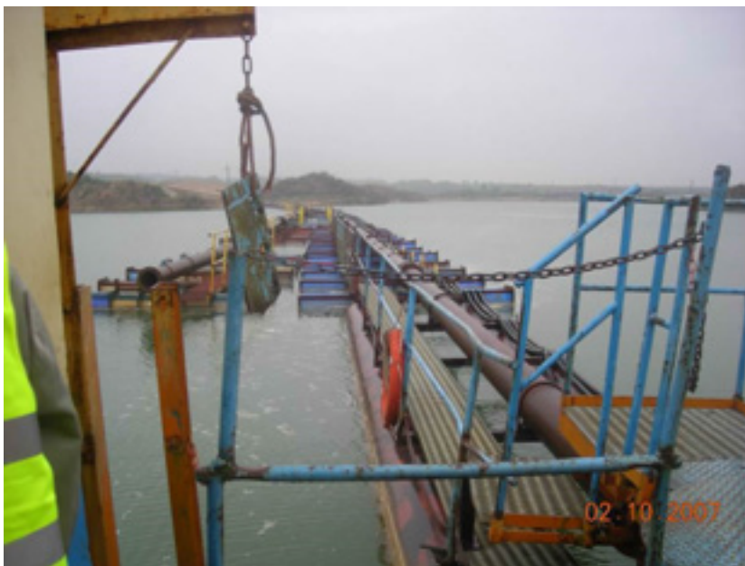
Fot. 12 Rurociąg odstawy urobku do zakładu przeróbczego (źródło: Z. Schmidt 02.10.2007).
