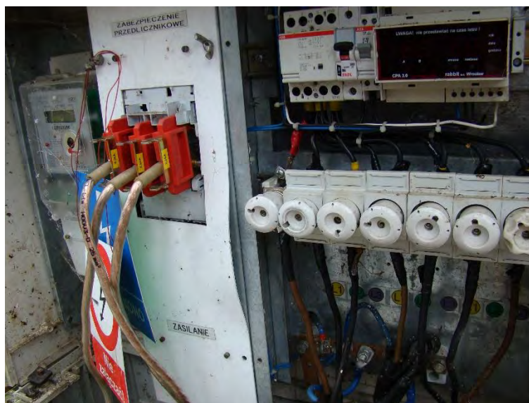
Rys.3.2. Widok wyposażenia szafki oświetleniowej SO22
