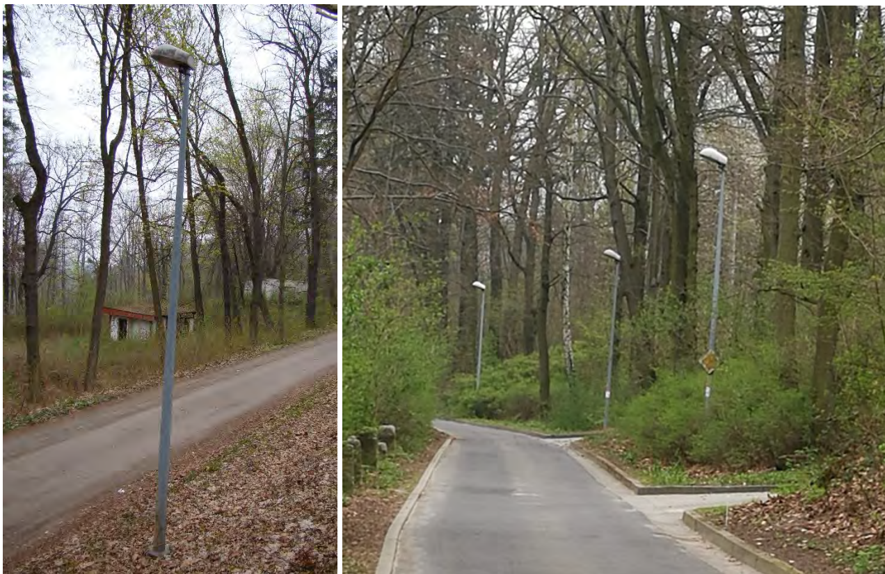
Rys. 7. Obecne oświetlenie na ulicy Granicznej/Kombatantów w Lwówku Śląskim (stan na IV.2019r.)
