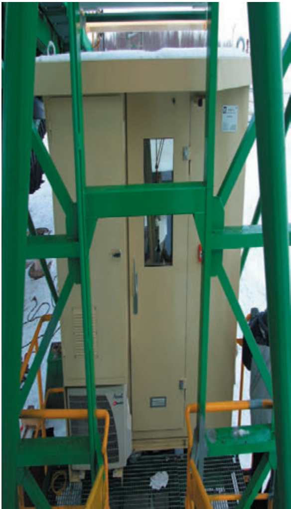
Rys. 6. Szafa techniczna na tylnej ścianie kabiny
